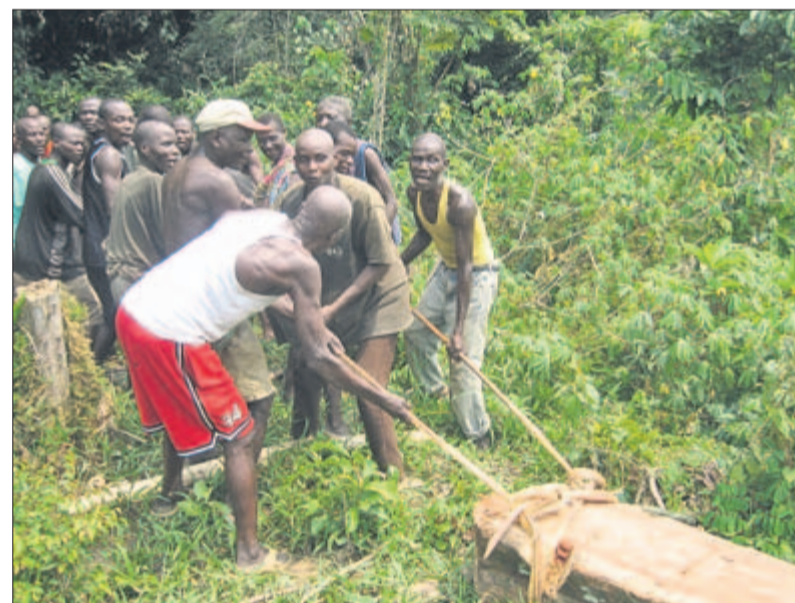
Brückenbau im Urwald ist noch Hand- und Schwerstarbeit. Aber Brücken ermöglichen Handel und verbessern die Lebenssituation. Foto: Verein Kongo
